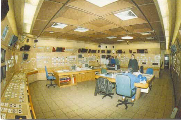
Αίθουσα ελέγχου πυρηνικού εργοστασίου στο Πενλύ της Γαλλίας
